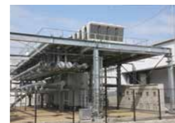
空調設備架台 架台上部の「チラー」の出口温度を通常より高く設定することで高効率運転を実現
