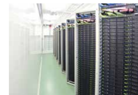
サーバを収納したラックが斜めに配置されたコンテナDCの内部
