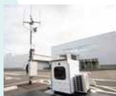
IIJ 白井データセンターキャンパスの マイクロデータセンター
